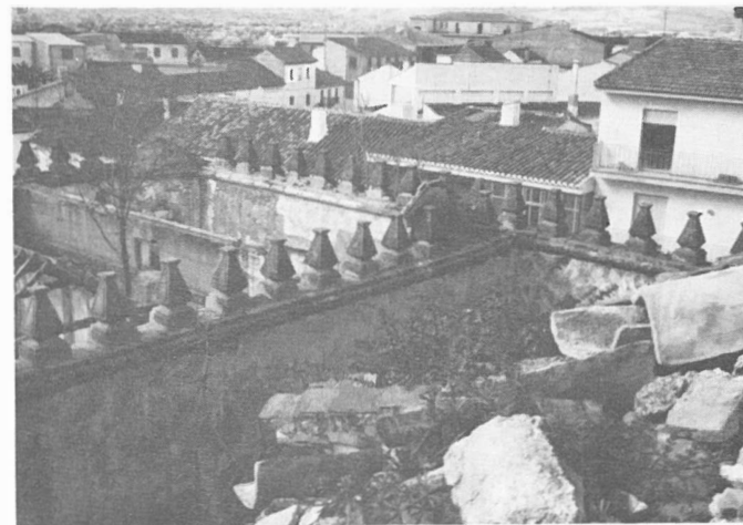
Fig. 3.- Vista de las almenas de forma piramidal que remata la muralla del recinto. (Tomada a finales de marzo de 1984 antes de comenzar su reconstrucción)
