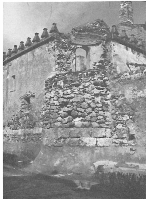
Fig. 2.- Cubo de uno de los ángulos que quedaron destruidos en el terremoto que tuvo lugar en la Navidad de 1884. Antes de su restauración
