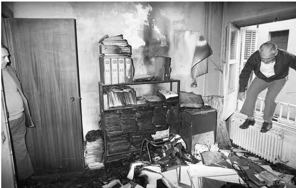
Incendio en la sede del PCE de Granada en octubre de 1984. / JUAN ORTIZ
