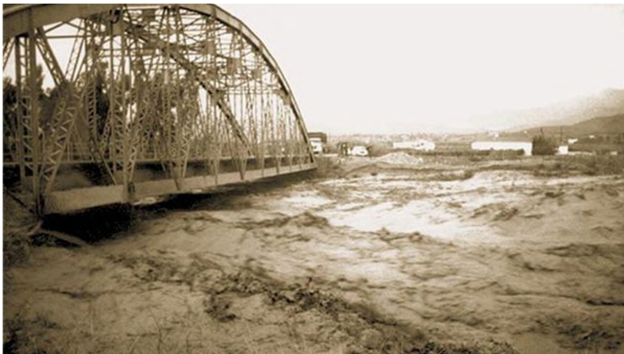
El puente de la Maquinilla quedó hecho un amasijo de hierro tras las riadas de La Rábita / G. A. A.
