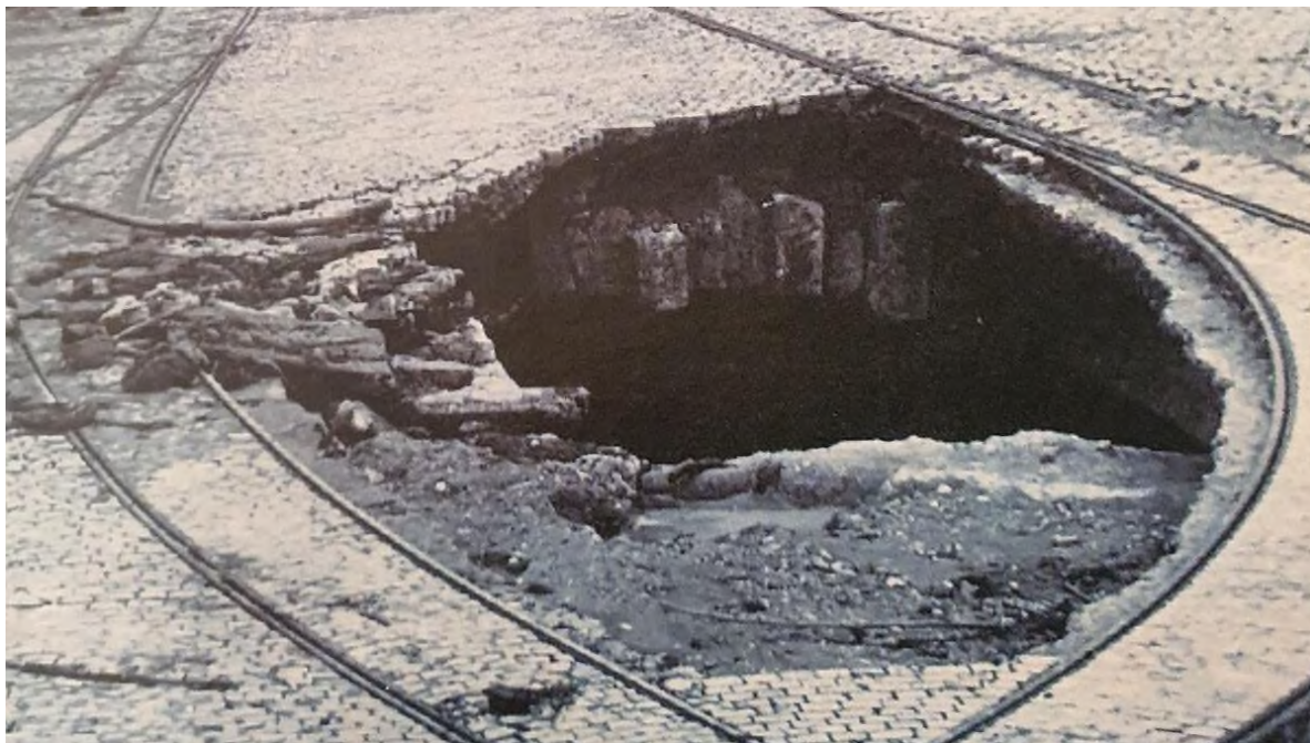
Socavón que dejó el reventón del Darro en Puerta Real / TORRES MOLINA
