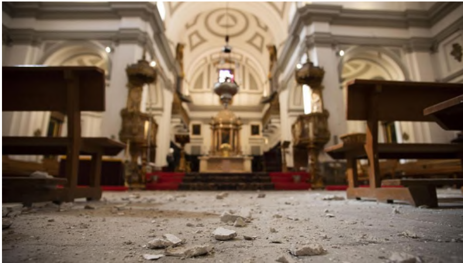
Daño en la Parroquia de La Encarnación, en Santa Fe, a raíz del enjambre sísmico
