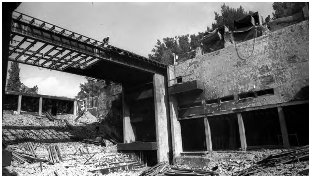
Estado del auditorio Manuel de Falla tras el incendio
