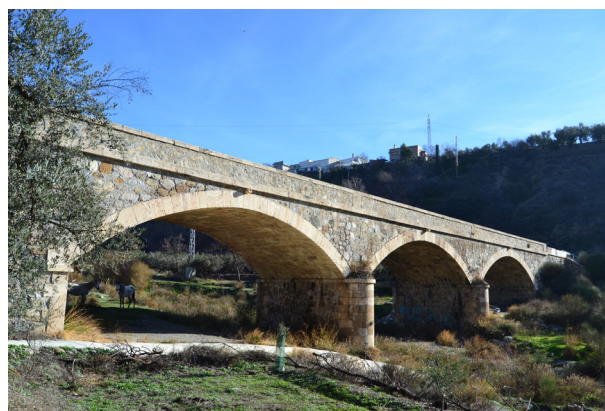
Fig. 9. Puente sobre el río Torrente. Carretera de 2.º orden de Granada a Motril. Fotografía: Autores.
